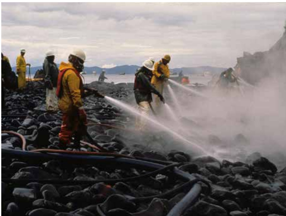
ניסיון הניקיון בחופי מפרץ וויליאם סאונד, בעקבות דליפת הנפט של "אקסון ואלדז". מקור: ARLIS (Alaska Resources Library & Information Services)
